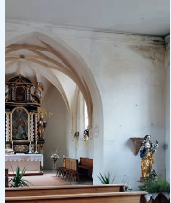
Schäden durch Wassereintritt im Innern der Kirche.
